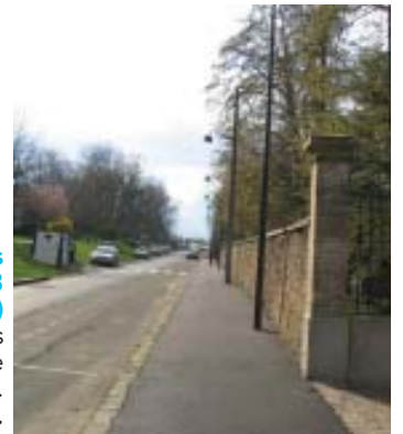
Rue de Paris (du pont de la N 118 à l'avenue Parrat) réfection des trottoirs et de l'éclairage public. Coût : 212 000 €.
